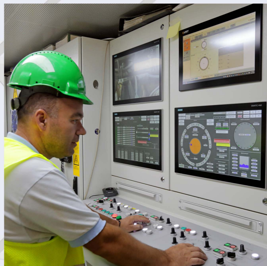
Πιλοτήριο TBM «ΑΘΗΝΑ».
